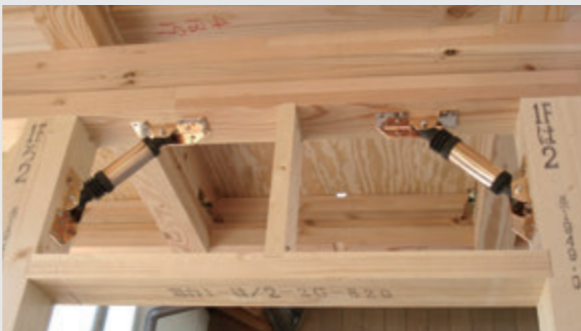
建物に均一に配置するよう内壁に取り付けた「安震くん」
