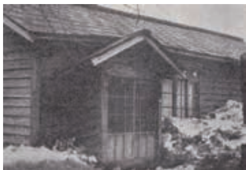
写真 2.1.1 凍上による被害
