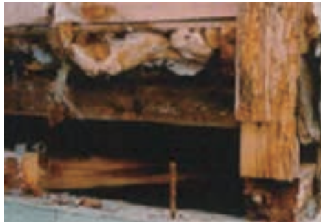
写真 4.1.3 結露による腐朽
