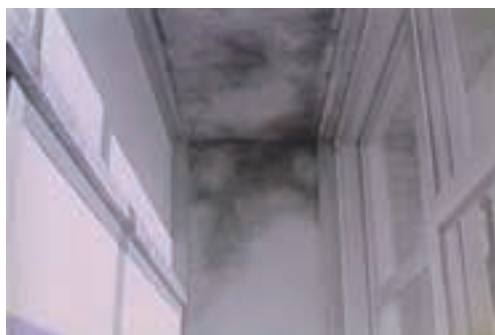
写真 2.1.2 すがもれによる被害
