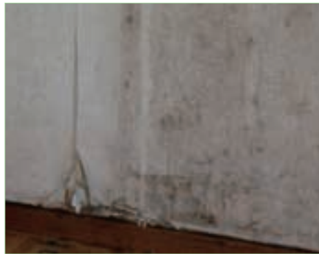
写真 4.1.2 カビによる汚損
